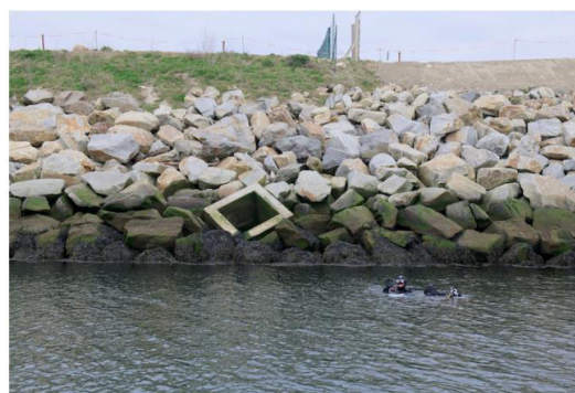
Figure 44 Exemple d'éco-bloc dans la digue du port (Bouchoucha et al. 2022)
